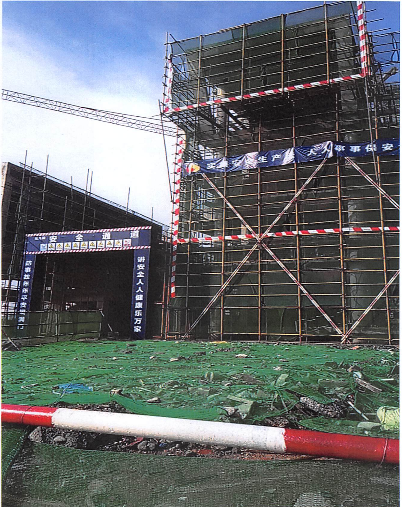
1#商铺墙体砌筑基本完成，内粉完成 80%，外粉完成 80%；2#商铺墙体砌筑完成 65%；幼儿园墙体砌筑完成 75%。
